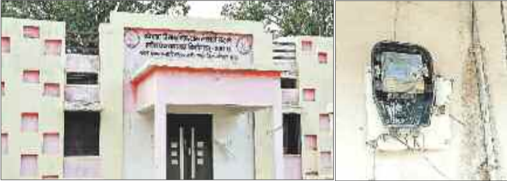
पंचायत भवन जहां दिया गया बिजली कनेक्शन तथा वहां लगा हुआ विद्युत मीटर।
